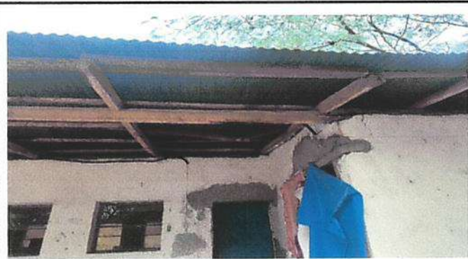
Foto 3: Daño de estructura del modulo 2 de aulas.
