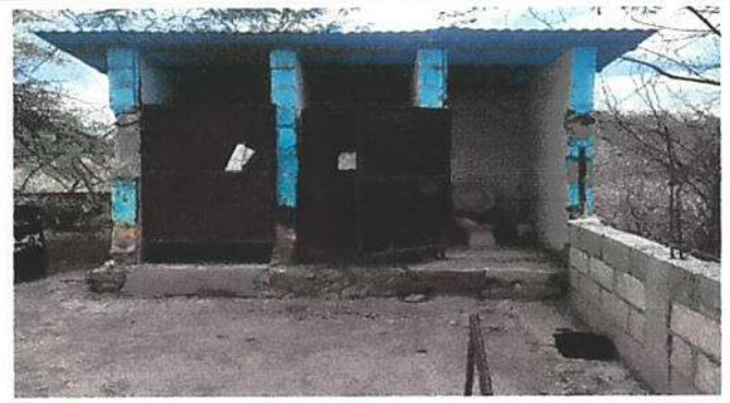
Foto 2: Modulo de baños en mal estado.
